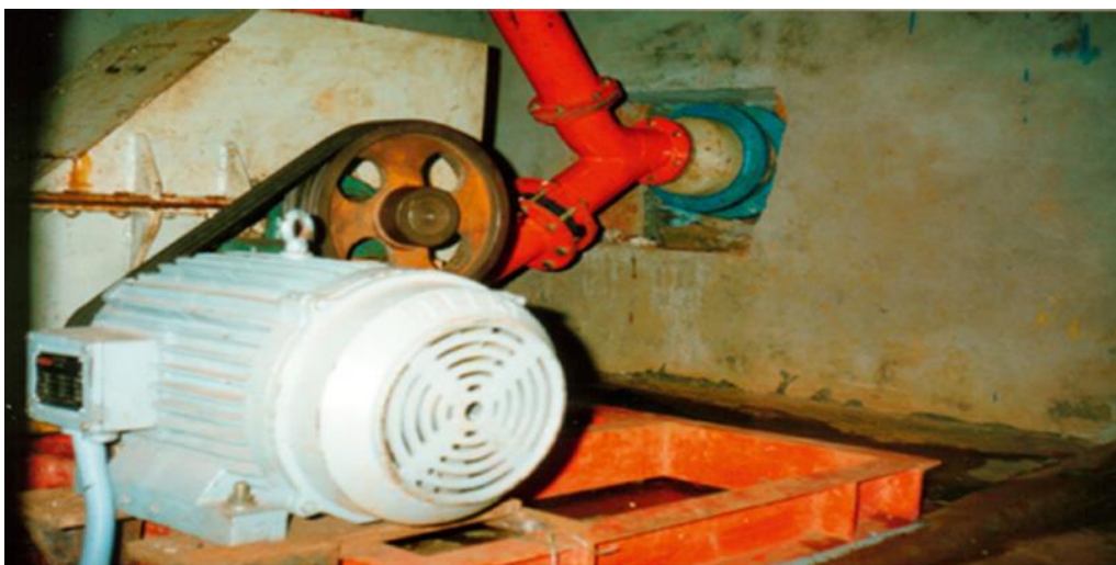
Рисунок 1.19. Узел турбины / АМГС, установленный в полевых условиях
